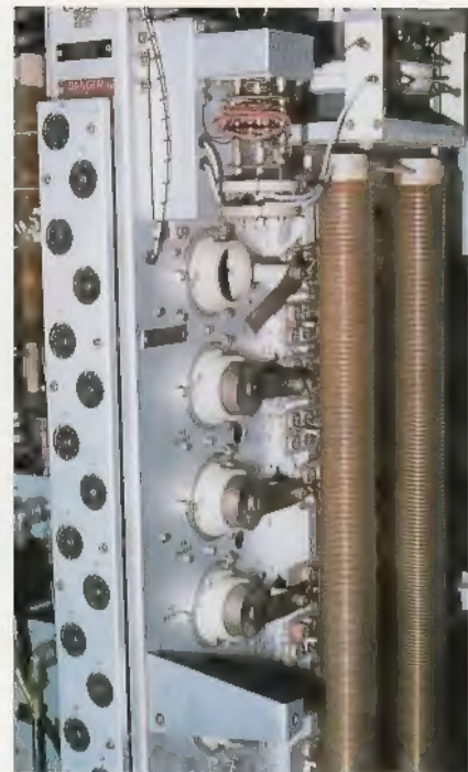
Details 1 kiloWatt zender, de eindtrap met 16 buizen.
